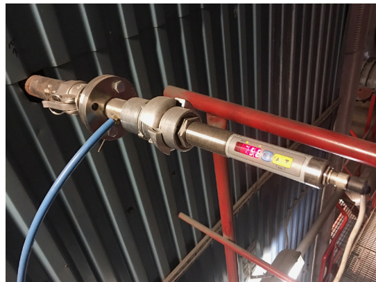
CellaTemp PK 71 installerad i befintligt uttag för termoelement
