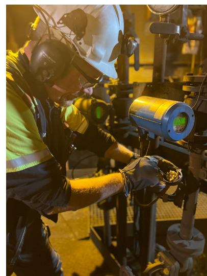
Temperaturgivare TRA-S12 installerad i kylvattenledning
